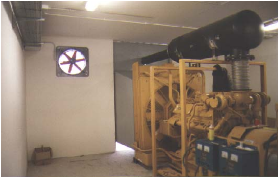
650 KVA GENERATOR ROOM
